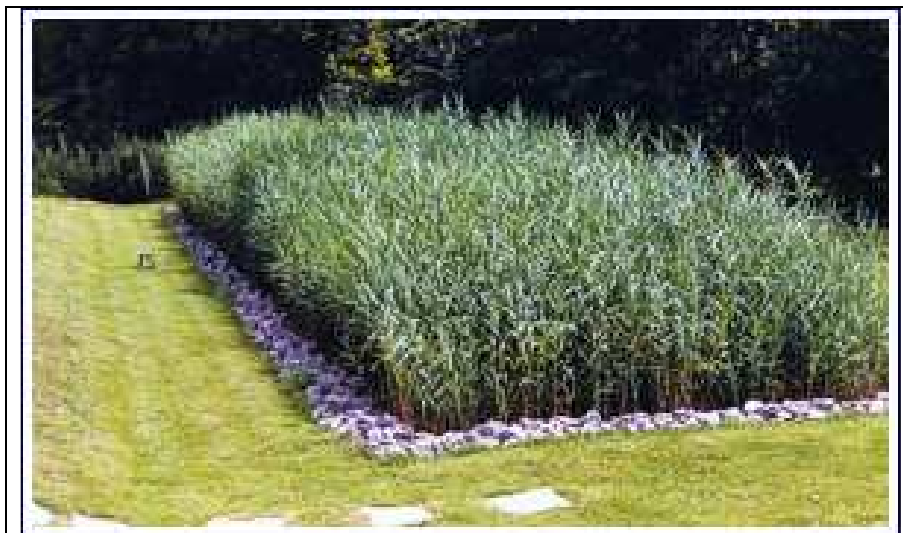
Fig. 1: vasca di fitodepurazione a flusso sub-superficiale
