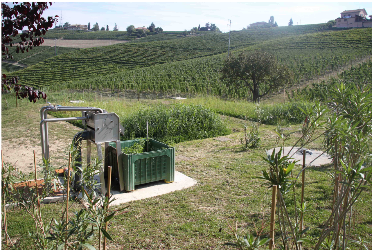
Un impianto di fitodepurazione nelle Langhe
